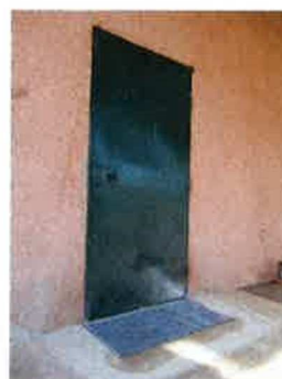
Seuil sans ressaut et grille PMR Entrée Maison du Football
